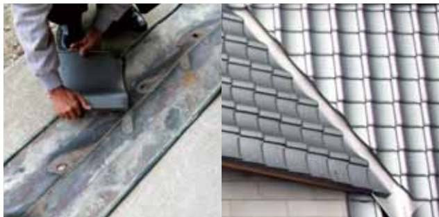
銅製谷樋の孔食とチタン谷樋の適用例
